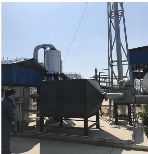
油气回收装置
