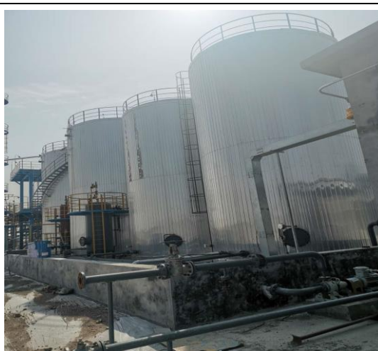
尾气处理装置配套罐区
